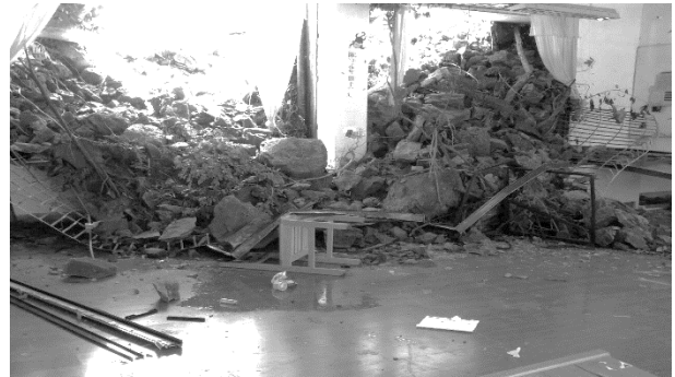
圖 2 學校後山土石崩落沖毀教室門窗牆壁
